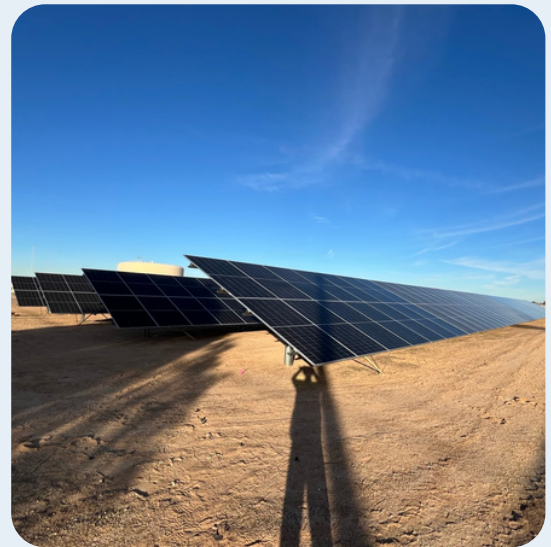
Kiowa Solar Generation Project
