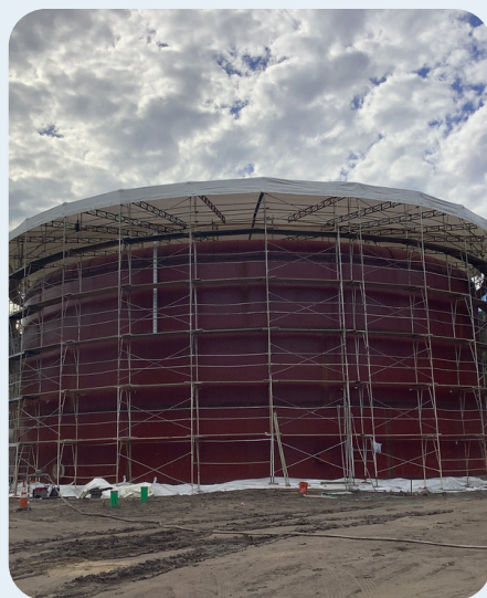
Depósito y Tubería Kelt (Sistema de Agua de Orcutt)
