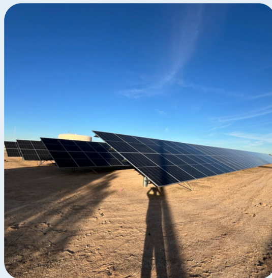
Kiowa Solar Generation Project
